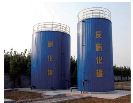
北京六里屯垃圾渗滤液工程
