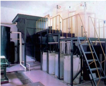
北京丰台造币厂电镀废水工程(40T/H)
