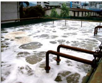
昆明高上高生猪屠宰废水工程
