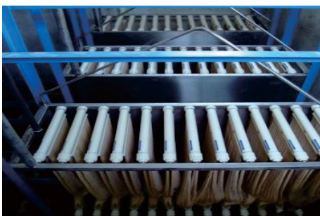
北京财源中心中水处理工程 (MBR工艺)
