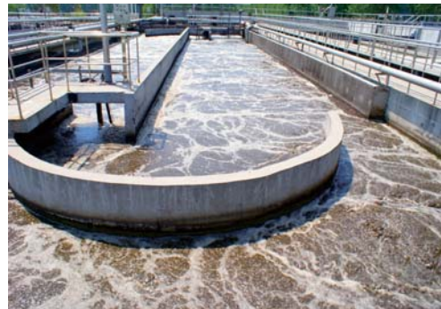
青海电化厂污水处理工程
