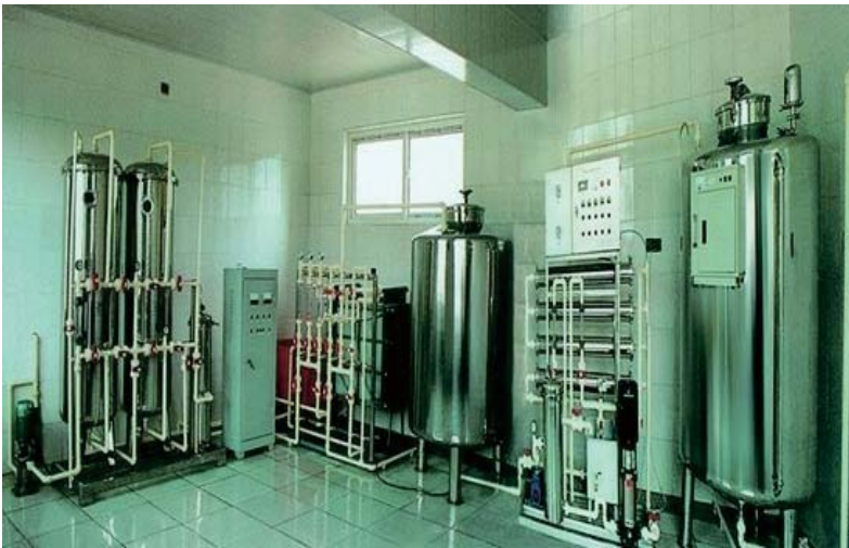
豪庭公寓直饮水处理工程 (1T/H)
